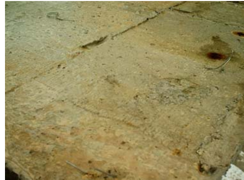
Anhaftungen von Kamilit sichtbar
