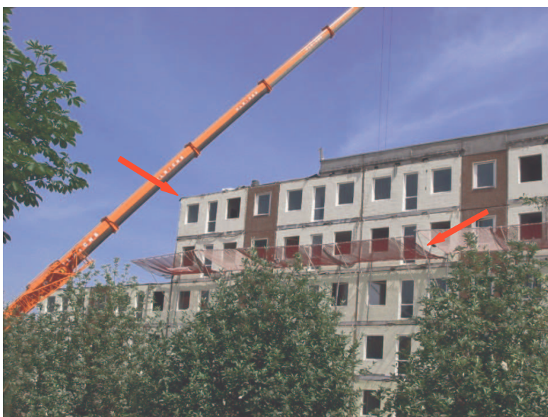
Bild 6: Auffangeinrichtung durch Auf- fangnetze
